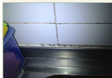
Presença de bolores junto ao lava louça e nas juntas dos azulejos
