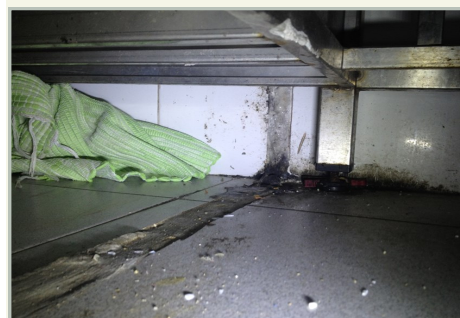
Detritos (lixos) por baixo da bancada
